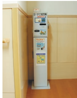
カード販売機 (各病棟)
